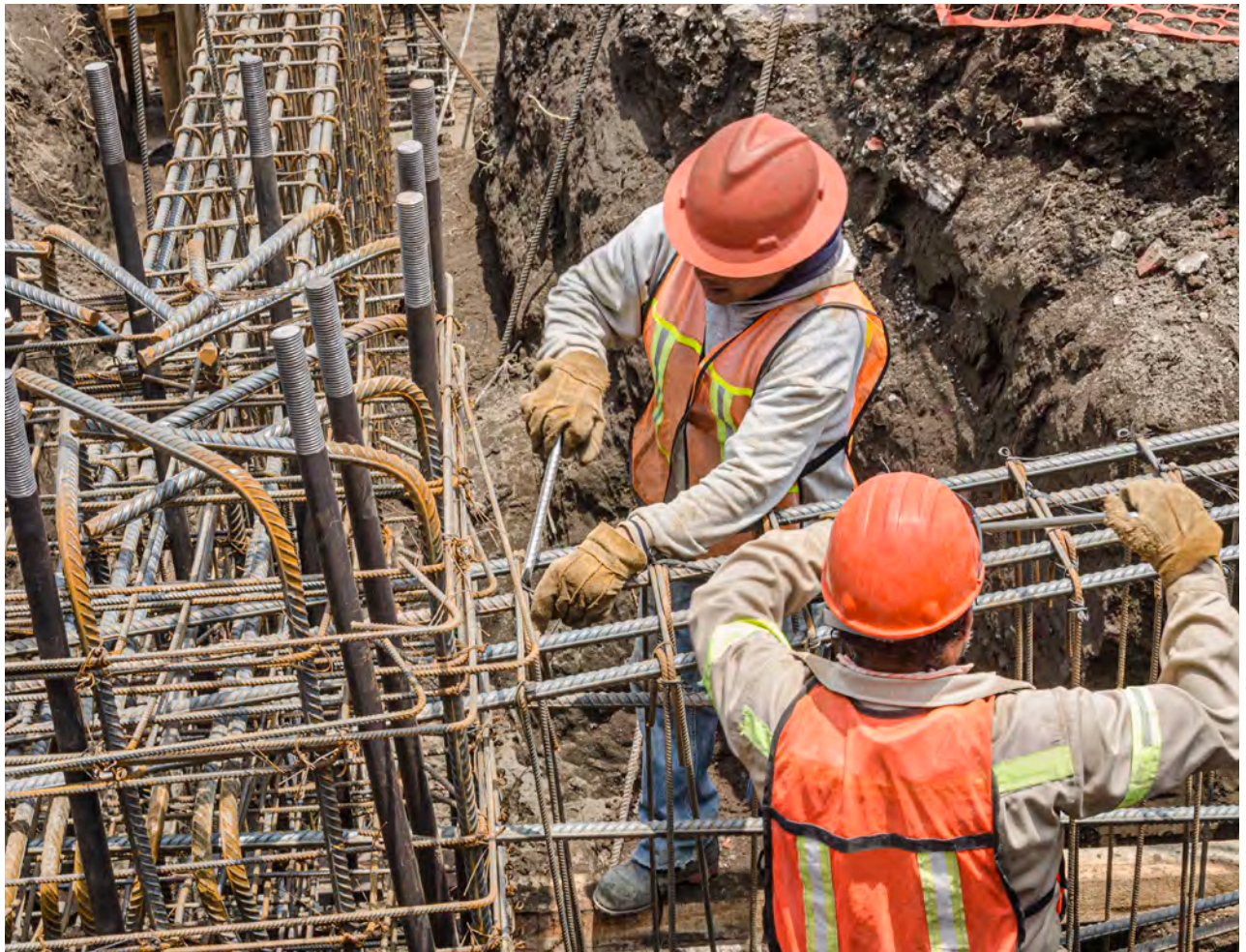
Trabajadores de la construcción que ponen los cimientos con barras de hierro/mofles/istockphoto.
